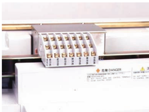
Fig. 15 Terminales del circuito de control
